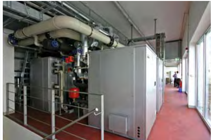
Die vier Yazaki-Absorptionskältemaschinen arbeiten auffällig leise
