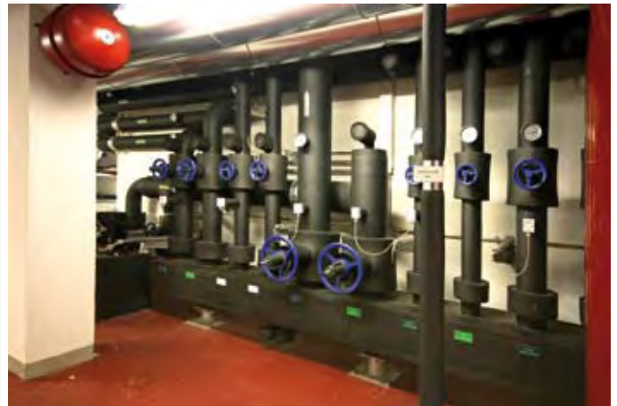
Zur Deckung des steigenden Kältebedarfs ist eine 5. AKM bereits eingepflanzt
