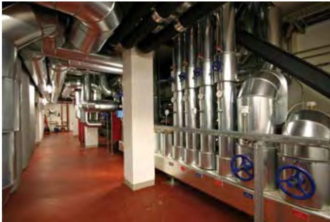
Heizverteiler für Verwaltungsgebäude und Produktion
