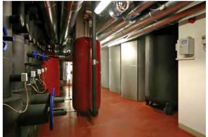
Kälteverteiler (links) und Wärme- bzw. Kälte-Pufferspeicher (rechts)
